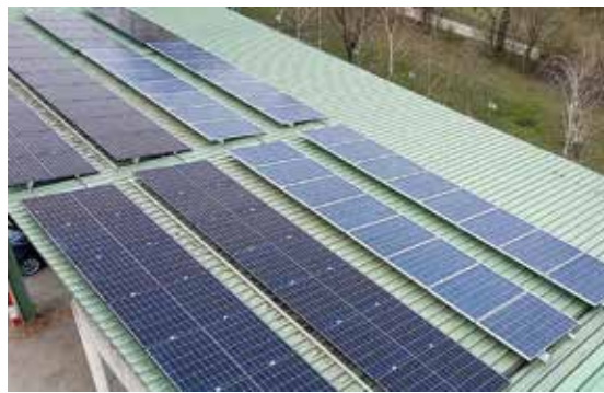
Die Photovoltaikanlage in der Kompostanlage Haschdorf wurde 2024 weiter ausgebaut.
